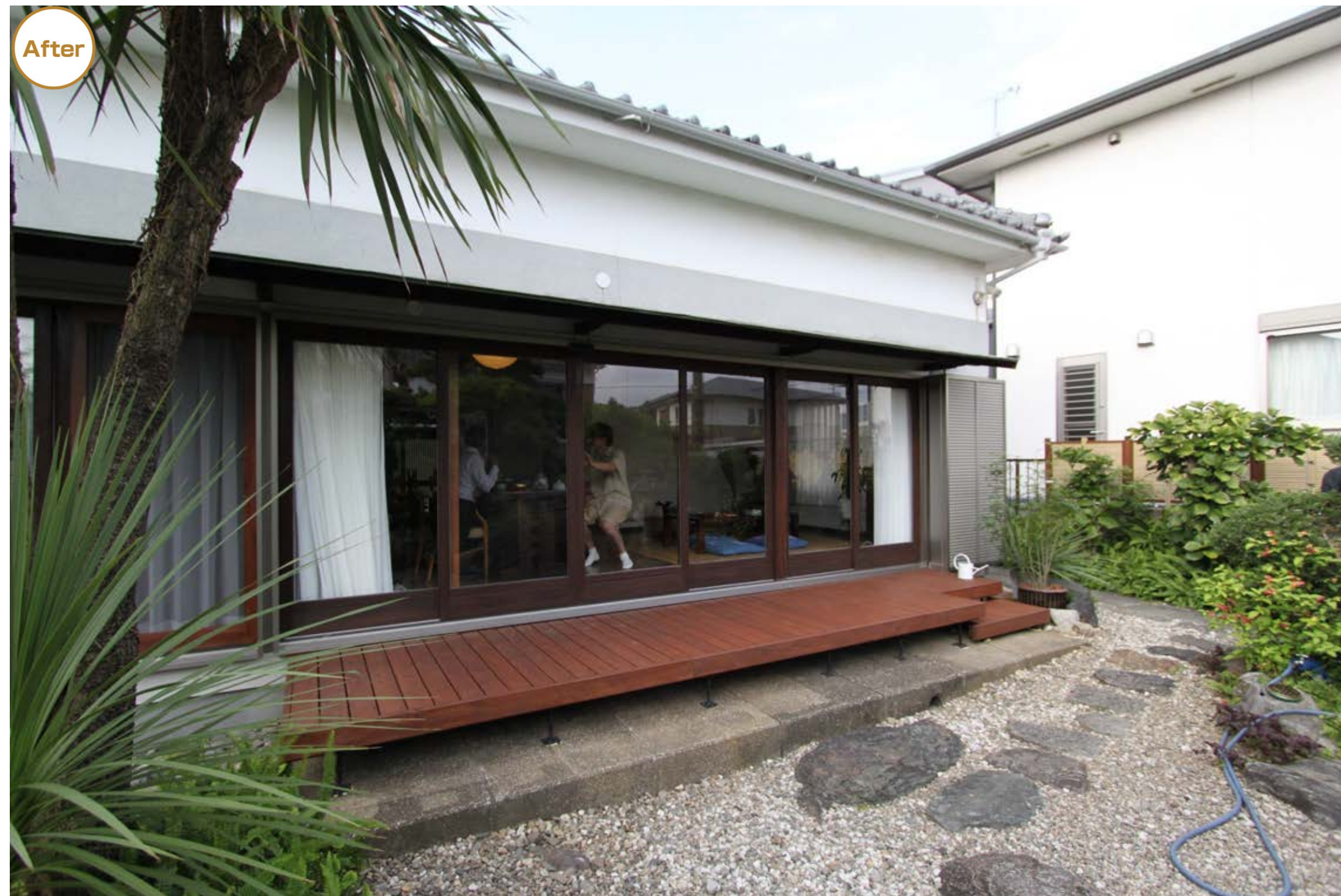
LDKの大きな窓全面に接するウッドデッキを新設。ウッドデッキに腰かけてお気に入りの庭をゆっくり眺めたり、庭の手入れをする時間が増えたとご主人。
